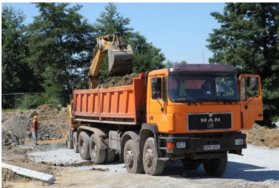
Fot 6 Załadunek pojazdu przeprowadzany przy wyłączonym silniku.
